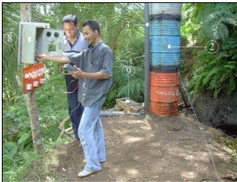
Gambar 5. Panel Kontrol Listrik pada Sistem PTMPMD
