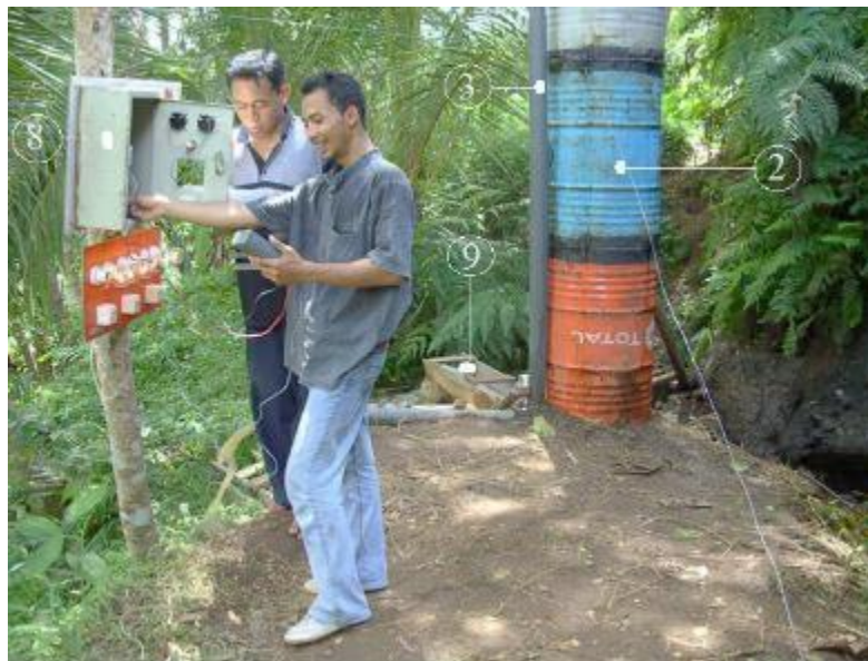
Gambar 5. Panel kontrol listrik pada sistem PTMPMD
