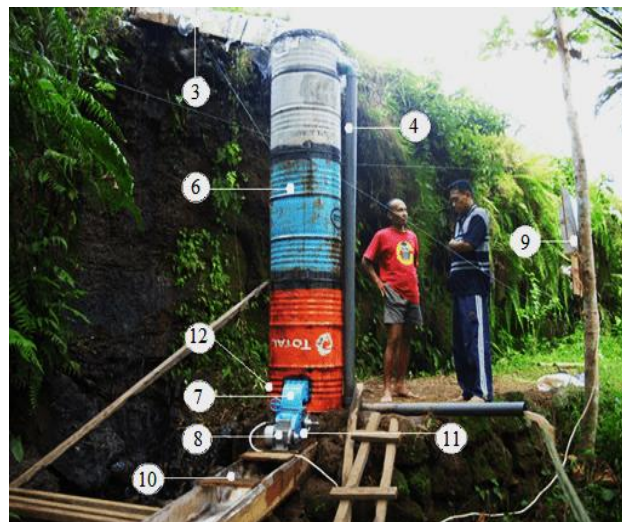
Gambar 12. Turbin Cross-flow saat terpasang pada sistem pembangkit listrik tenaga piko-hidro model drum di lapangan yang siap untuk diuji
